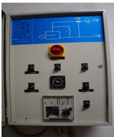
Figura 4.7 - Particolare del sistema di termoregolazione in CT
