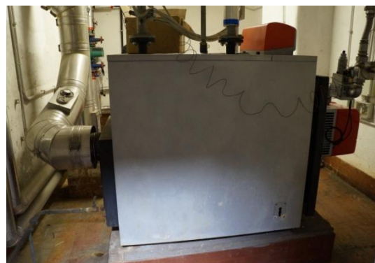
Figura 8.5 – Particolare generatore di calore
