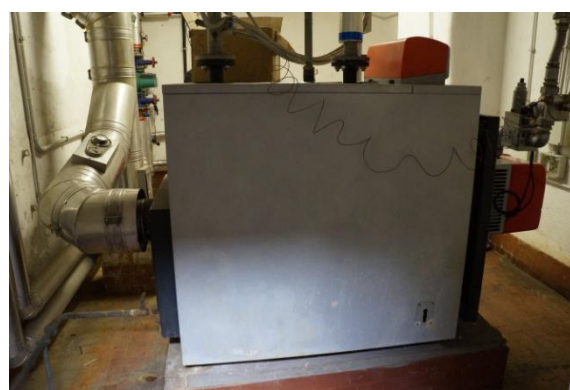
Figura 4.12 - Particolare del generatore di calore
