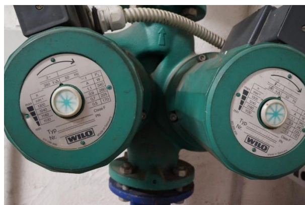
Figura 8.7 – Particolare pompe di circolazione
